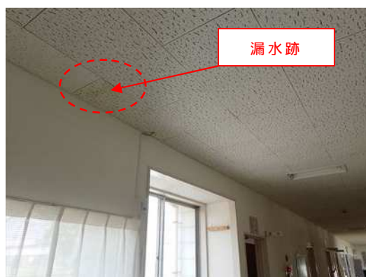
写-2.2.2 天井(漏水跡)【C判定】 (不動堂児童館)
