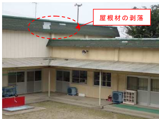
写-2.2.1 屋根(屋根材の剥落)【D判定】 (小牛田保育所分園)
