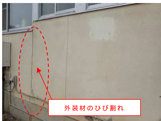
写-2.2.3 外構(ひび割れ)【D判定】 (小牛田保育所分園)
