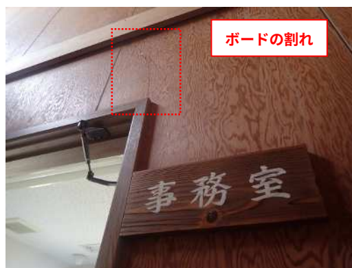
写 8 内壁：ボードのひび割れ【B判定】
