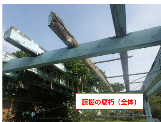
写 9 藤棚：腐朽【D判定】
