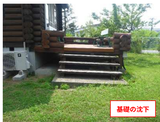
写 4 テラス：基礎の沈下【D判定】
