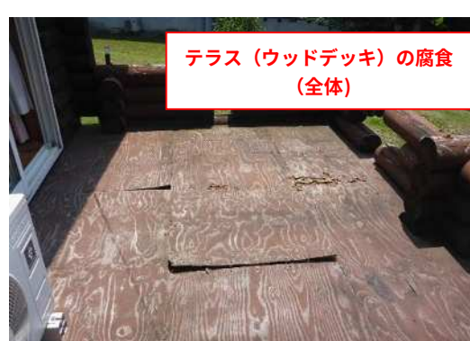
写 6 テラス (ウッドデッキ)：腐食【D判定】
