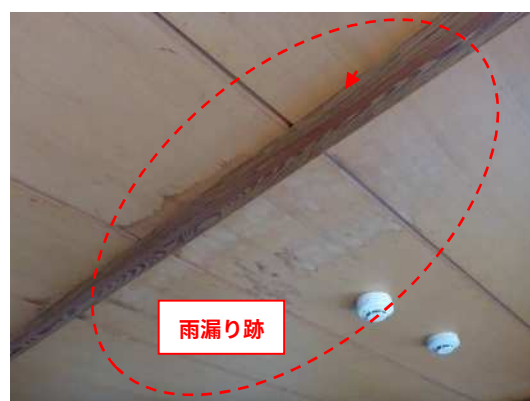
写 3 天井：雨漏り跡【C判定】
