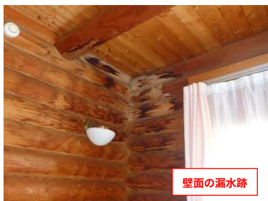
写 7 内壁：漏水跡 【D判定】
