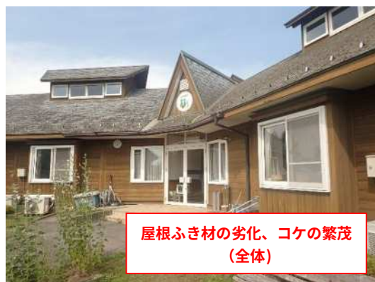
写 1 屋根：劣化、コケ繁茂【D判定】
