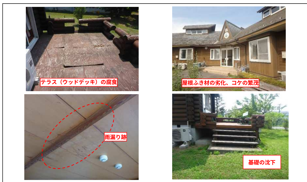
図 5 老朽化が進行している部材や設備
