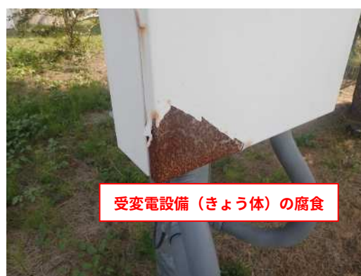
写 10 受変電設備：腐食【B判定】
