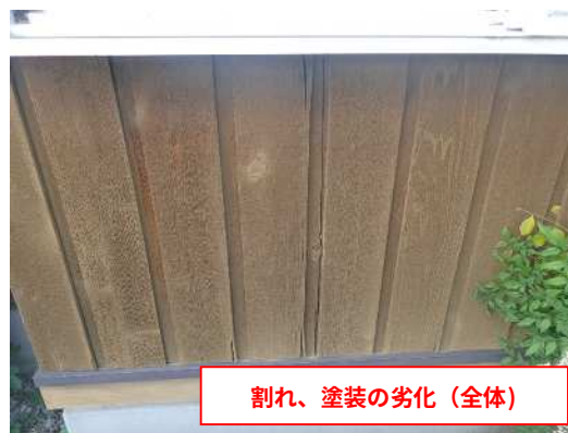
写 2 外壁：割れ、塗装劣化【D判定】
