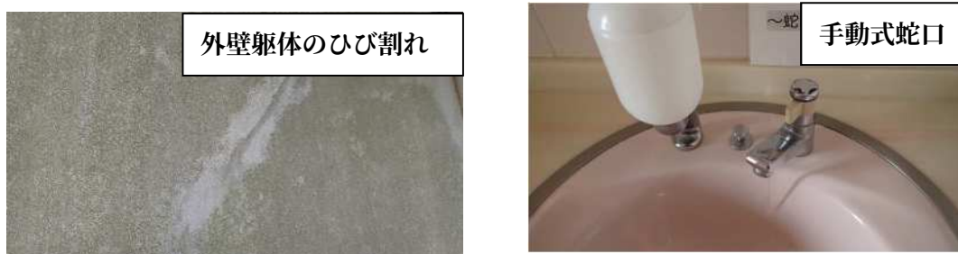
図 4 劣化した部材の例
