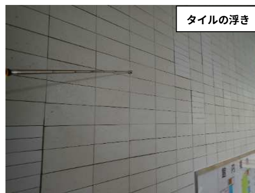
写 4 壁面：タイルの浮き【C判定】
