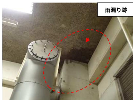
写 3 天井：雨漏り跡【C判定】
