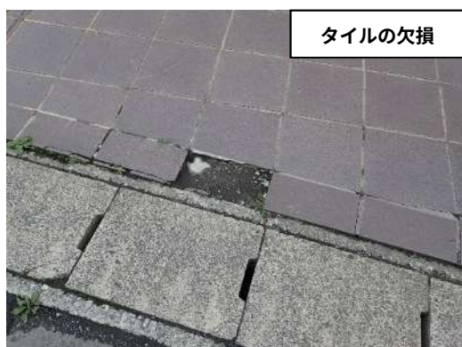
写 5 外構：タイルの欠損【B判定】
