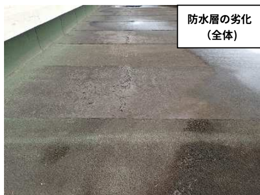
写 1 屋根：防水層の劣化【C判定】
