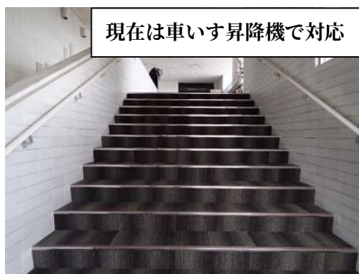
図 5 段差解消に対する改善が必要な例
