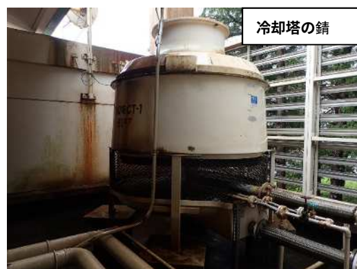
写 6 機械設備：錆あり【B判定】
