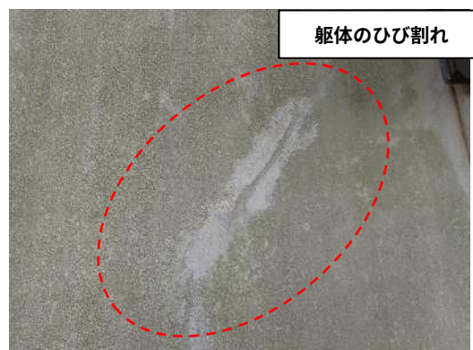
写 2 外壁：躯体のひび割れ【C判定】
