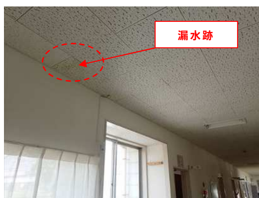
写-2.2.2 天井(漏水跡)【C判定】 (不動堂児童館)
