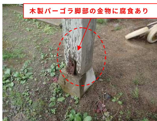
写-2.2.4 パーゴラ脚部(腐食)【C判定】 (南郷児童館)
