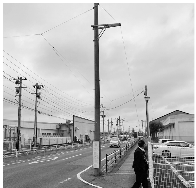
町道に敷設されている電柱
