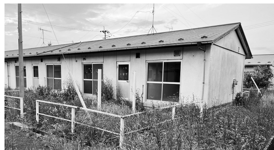
早期改修が待たれる住宅
