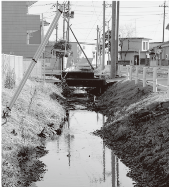
改良整備すべき土水路
