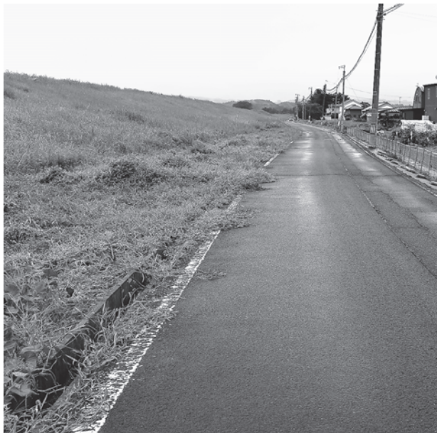
側溝蓋が必要な下小牛田線
