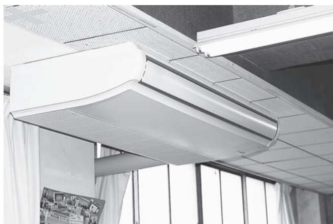
要望により設置されたエアコン
