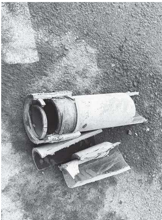
古い石綿管がまだ残っている
