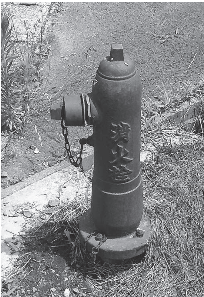
早急な修繕が求められる消火栓
