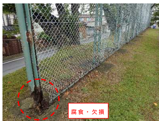
写-1.2.2 フェンス柱部腐食・欠損 (素山野球場)
