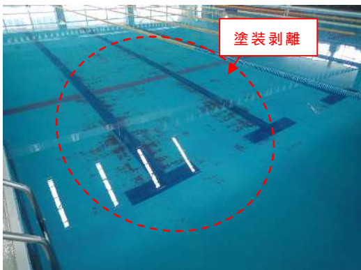
写-2.2.5 床仕上材(塗装剥離)【D判定】 (スイミングセンター)
