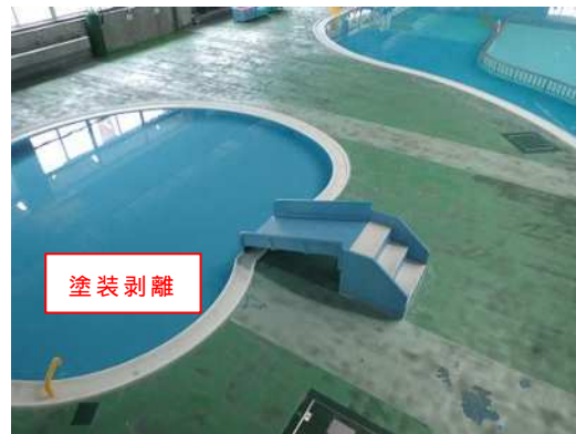
写-2.2.4 床仕上材(塗装剥離)【D判定】 (スイミングセンター)
