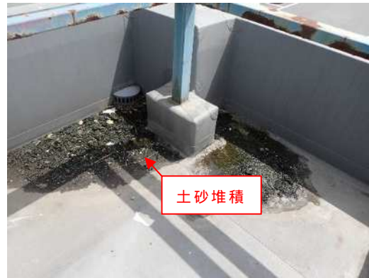
写-2.2.2 露出防水層(土砂堆積)【D判定】 (南郷体育館)
