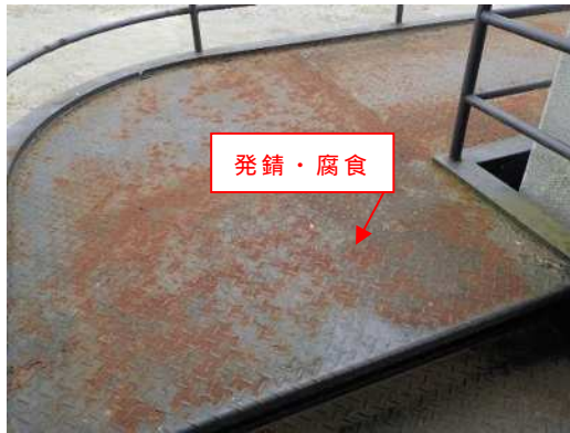
写-2.2.1 外部階段(発錆・腐食)【D判定】 (トレーニングセンター)
