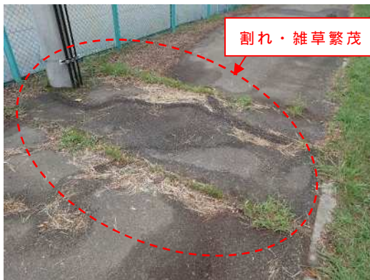
写-2.2.3 舗装(割れ・雑草繁茂)【D判定】 (牛飼テニスコート)
