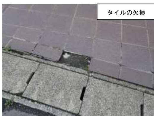
写 5 外構：タイルの欠損【B判定】
