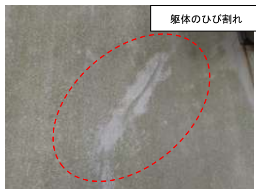
写 2 外壁：躯体のひび割れ【C判定】
