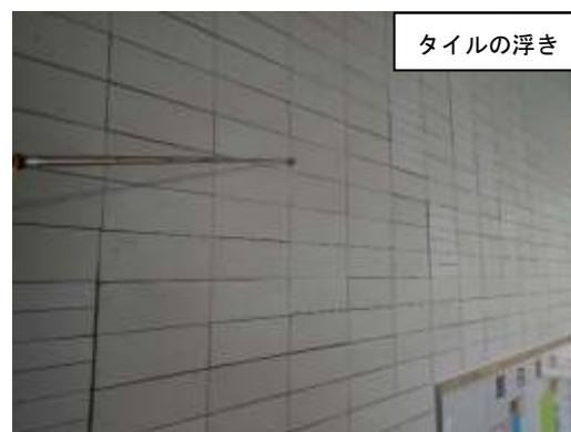
写 4 壁面：タイルの浮き【C判定】
