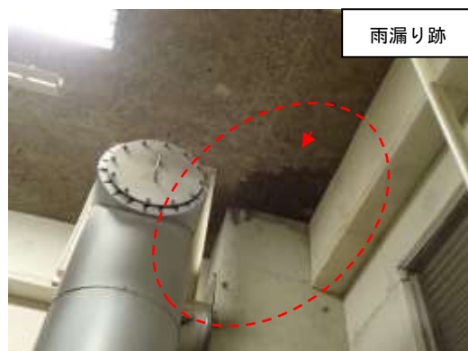
写 3 天井：雨漏り跡【C判定】
