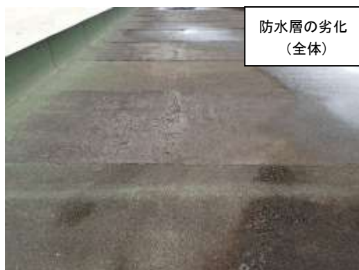
写 1 屋根：防水層の劣化【C判定】
