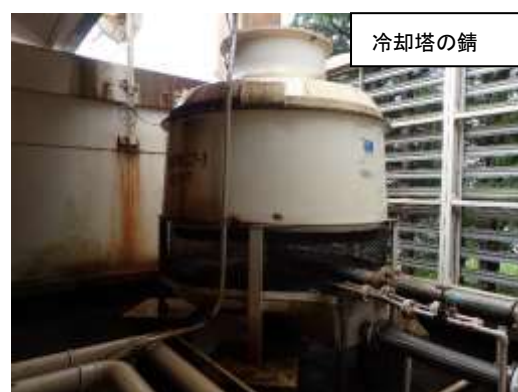
写 6 機械設備：錆あり【B判定】
