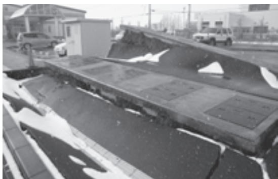
大地震で隆起した浄化槽
