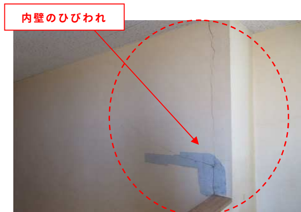
写-1.2.4 東日本大震災の被災箇所
