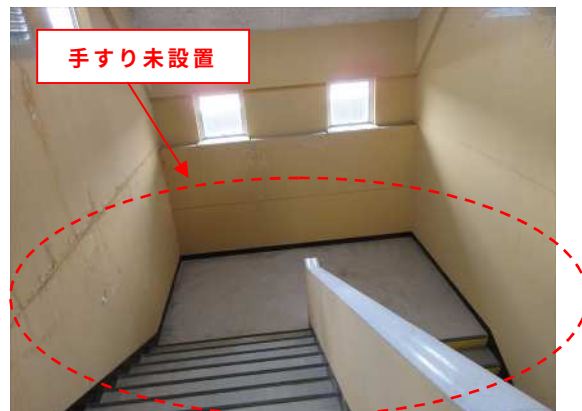
写-1.2.6 階段部の手摺未設置箇所
